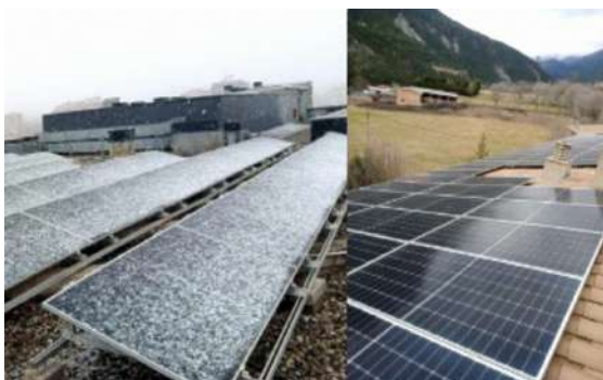
Placas fotovoltaicas instaladas en centros Colisée.
